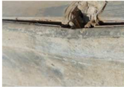
Zničený kotevný otvor a skrútený zvislý profil rámu
