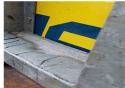
Deformácia panela – spojenie panelov upínačom nie je možné
