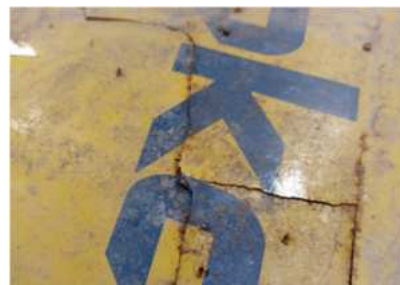
Trhliny v preglejke > 10 cm dlhé
