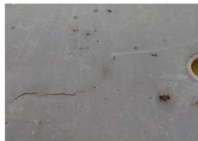
Trhliny v preglejke > 10 cm dlhé
