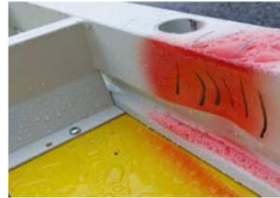
Deformácia pozdĺžneho profilu rámu
