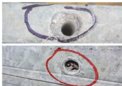
Otvory v profiloch poškodené alebo vyplnené betónom
