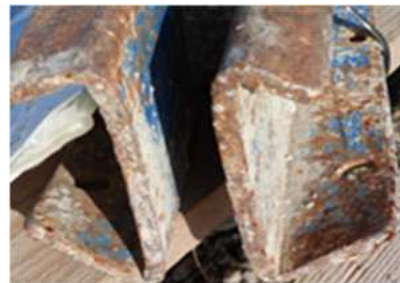
Skrútené a deformované > 5mm
