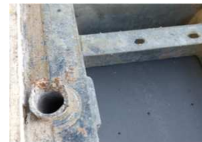
Chýbajúca / zničené ochrana kotevných otvorov
