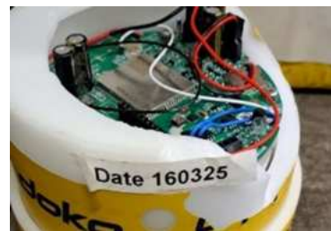
Poškodené alebo nefunkčné snímače
